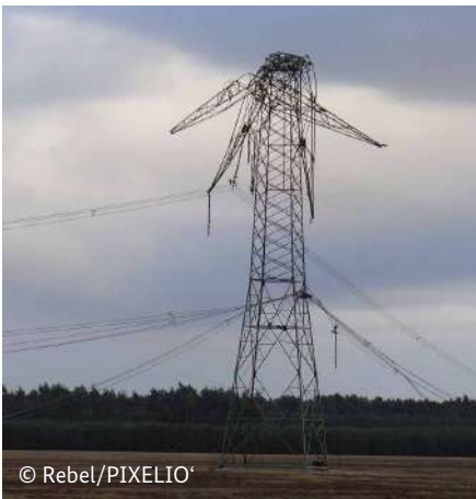
Sturmschaden durch den Orkan Kyrill im Jahr 2007
